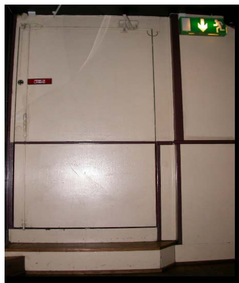
Bild 7.6 Utrymningsväg som är oattraktiv då den har samma färg och mönster som närliggande vägg
