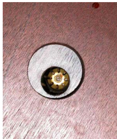
Bild 2.4 Sprinkler inbyggd i innertak
