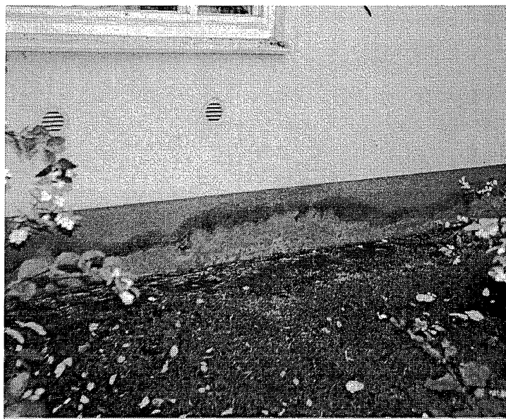
Figur 8.5: Svart missfärgning av sockel på ett av husen i kvarteret Majroparken. Det anmärkningsvärda med husfasaderna i kvarteret är dock att missfärgningarna har minskat kraftigt på naturlig väg det senaste året.
