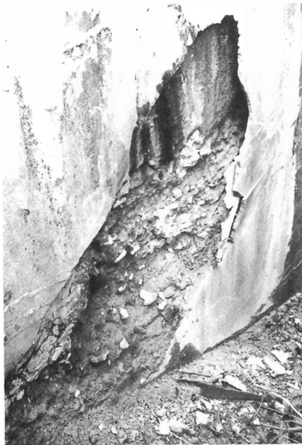
Fig 19. Majenfors. Porös, skadad betong. Armeringen i denna betong var dock utan rostangrepp.
