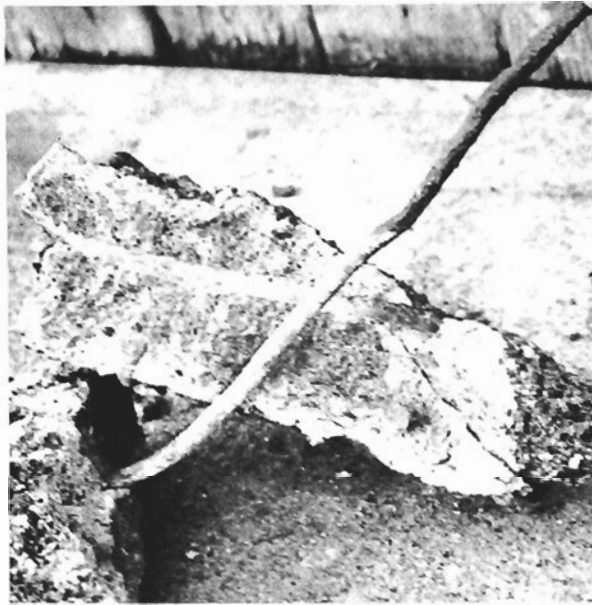
Fig 6. Laxviken. Brottstycke av betong med armering. De delar av järnet som exponerats i fria luften är kraftigt korroderade, medan de delar av järnen som varit tätt omslutna av betong är oangripna av rost.
