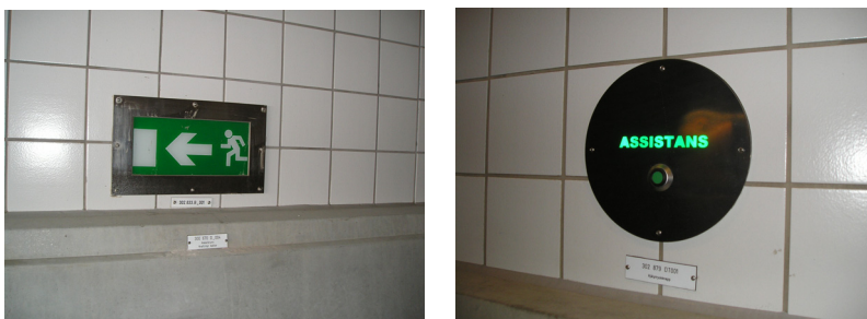
Figur 6. Vägledande markering och assistansknapp monterad i tunneln.
