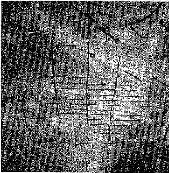
Fig 3 b. Skadegrad 2 (underkantsarmeringen delvis synlig).
