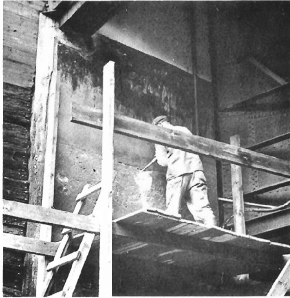
Fig 18. Bergvik. Friläggning av armeringen vid en fog inom vattenlinjenivån vid intaget till en av turbinsumparna.
