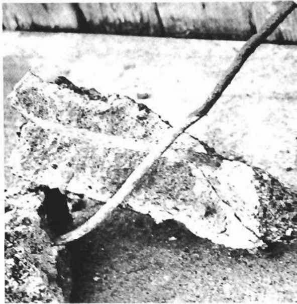
Fig 6. Laxviken. Brottstycke av betong med armering. De delar av järnet som exponerats i fria luften är kraftigt korroderade, medan de delar av järnen som varit tätt omslutna av betong är oangripna av rost.
