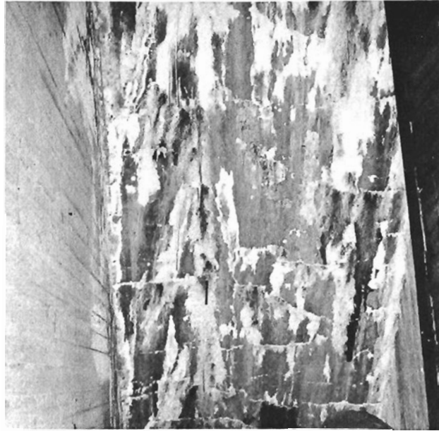
Fig 56. Krångfors Kraftstation. Sprickbildning och kalkurlakning vid frontplatta i anslutningsdamm. (Byggnadsår 1928)
