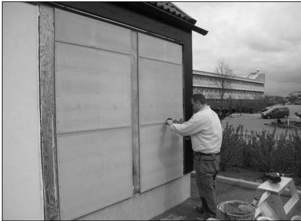
2008-04-17: Skivor Aquapanel Outdoor har monterats mot bakomliggande 25 mm tjocka träläkt. Skarv mellan skivorna cirka 3-5 mm spacklas ut med SERPO 610 Multi Flex .
