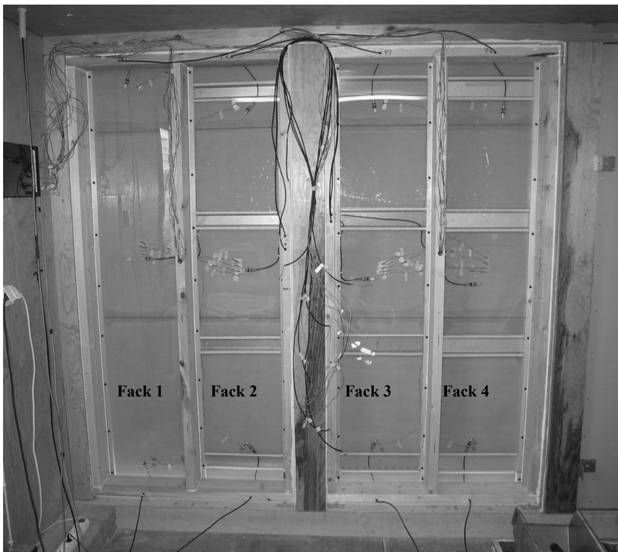
Figur 6-2 Experimentväggar med installerade givare i vy inifrån.
