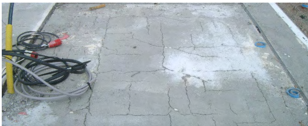
Figur 3-4 Plastiska krympsprickor orsakade av bristfällig fukthärdning av ytan vid gjutning med självtorkande betong. Bildkälla: Skanska Sverige AB
