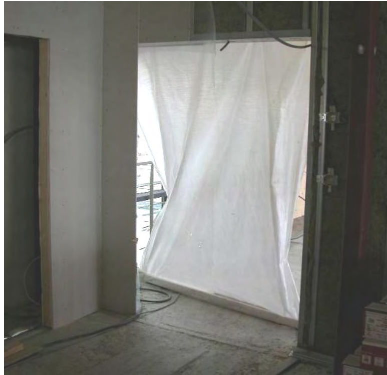
Figur 3-2 Misslyckad dörrtätning utförd med plast och träregel mot utomhusmiljö. Bildkälla: Skanska Sverige AB
