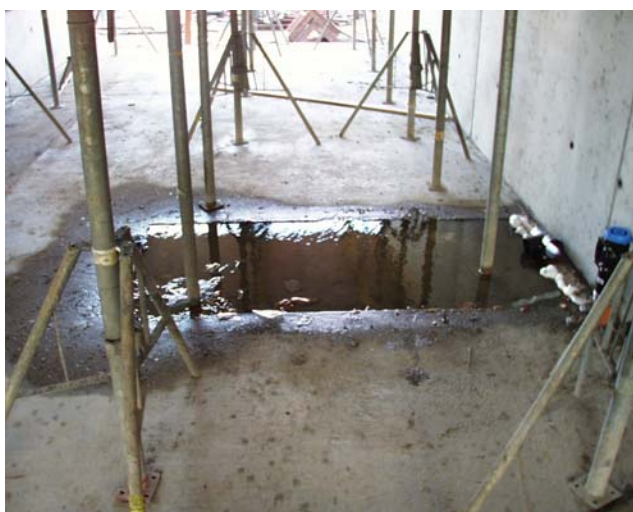
Figur 5.1 Vattenansamling i samband med nyproduktion.
