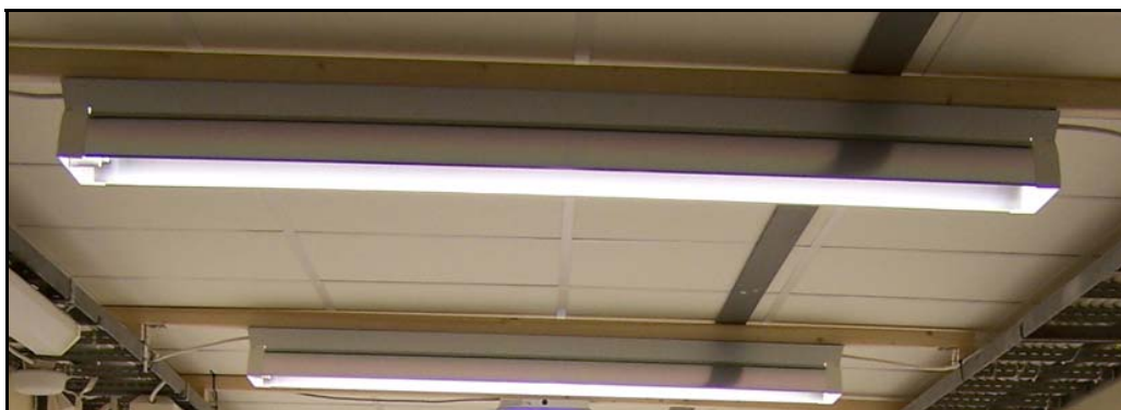
Figur 4:5 Lysrörsarmatur monterad i taket.
