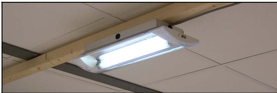
Figur 4:6 Nödbelysningsarmatur monterad i taket.
