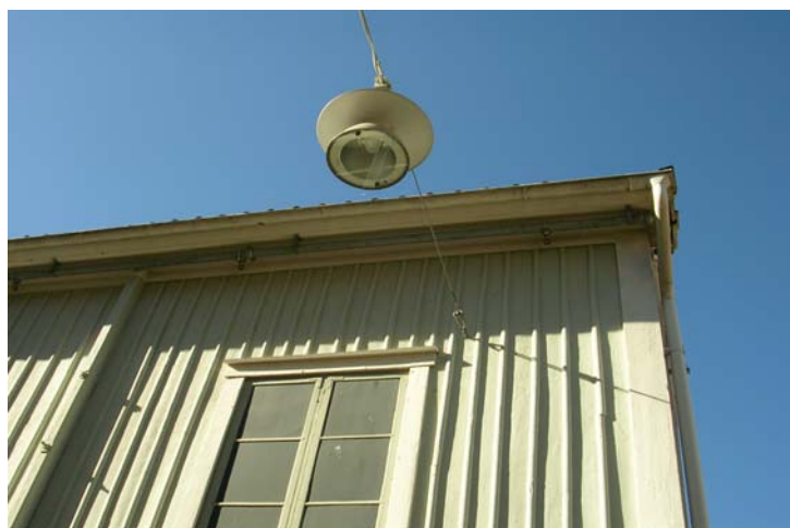
Bild 4 Fasadsprinkler under takfot.
