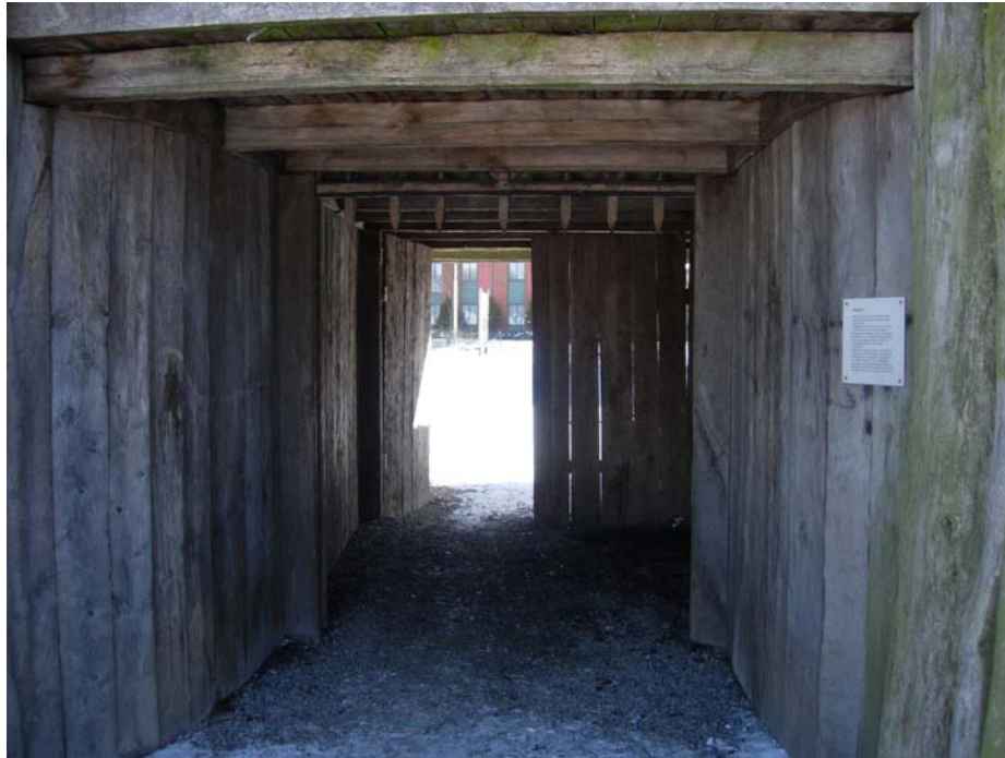
Bild 8. Portgången. Informationsskylten till höger berättar om det fällgaller som antyds i taket. Foto: T.Widerberg ©
