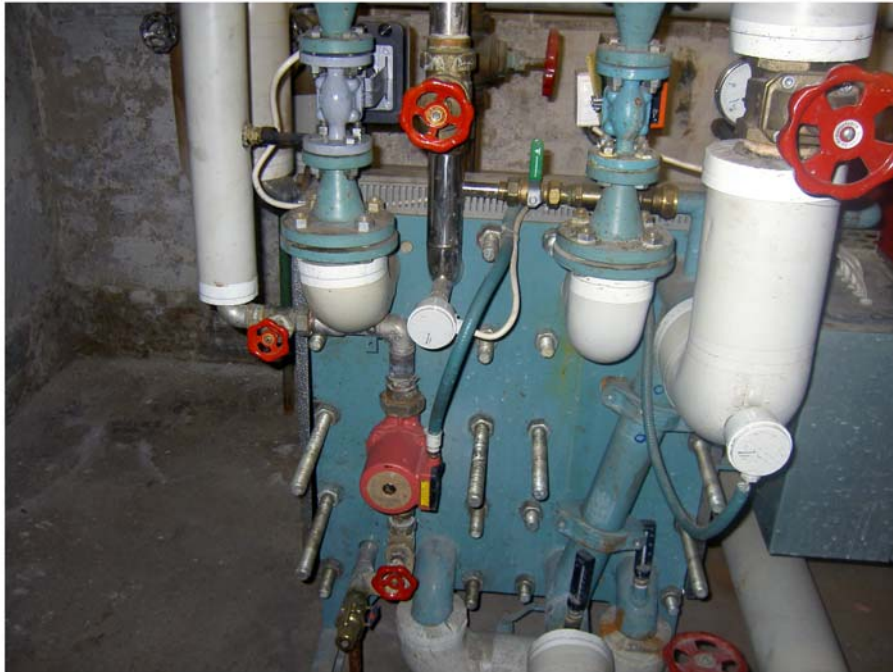
Figur 4.3. Värmeväxlare på David Hallstorg 10 för fjärrvärme till både varm- och varmvatten [ eget material].
