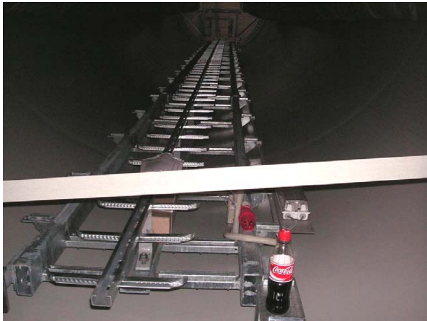
Figur 37 Stege och kabelstege införd i sektion på E-82 195
