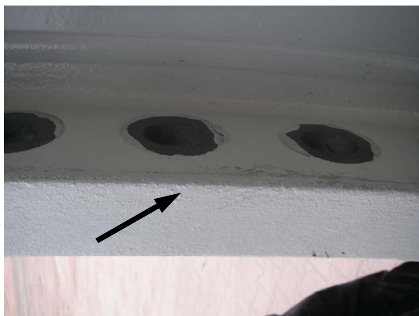
Figur 33 Deformation av flänsens insida 189
