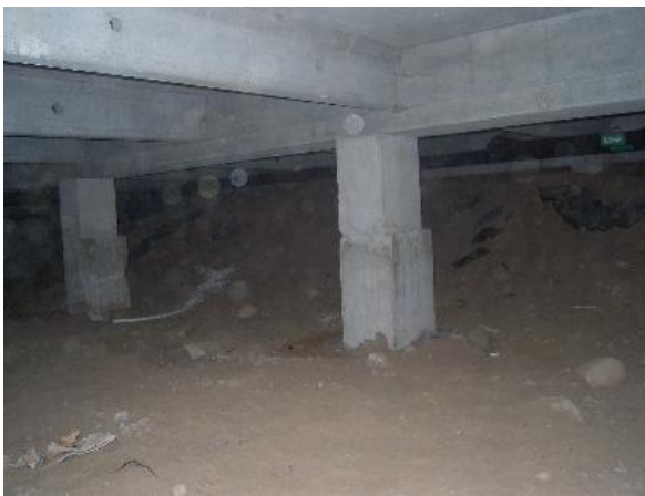
Figur 7. Jordmassor har rasat in i krypgrund A under de prefabricerade kantbalkarna.
