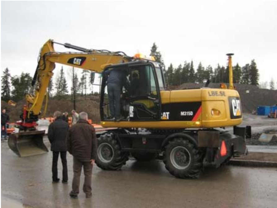
Figur 9. Grävmaskin med GPS-styrning (Bild taget vid Skogs Ekebyprojekt NCC, Stockholm). Foto: Christian Cruz
