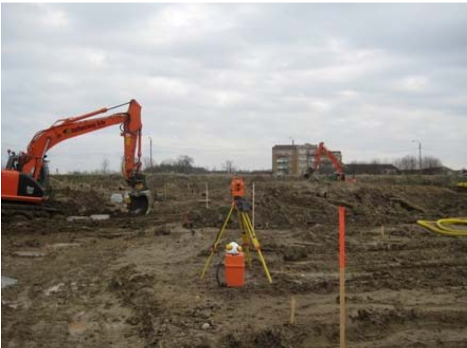
Figur 3. Grävmaskiner schaktar efter stakkäppar som ger information om riktning och djup (Bild från Annehemsprojekt NCC, Lund). Foto: Christian Cruz
