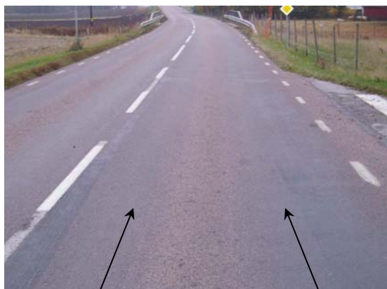
Fig 6.6: Väg 1017 mellan väg 995 och 1001 mellan sektion 0/240 och 1/020, sektion 1 i diagram 6.4. En tydlig blödning finns i hjulspåren
