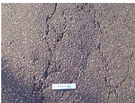
Fig 6.10: Mindre sprickor på väg 1538, sektion 1.
