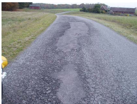
Fig 6.11: Stensläpp och krackeleringar på väg 990
