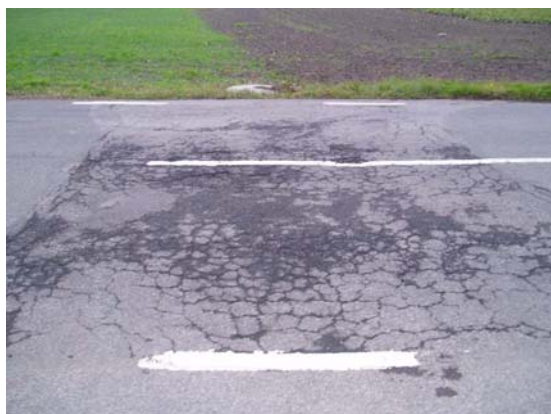
Fig 6.8: Lokal skada på väg 1017, sektion 0/220.
