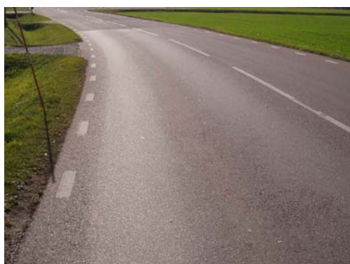
Fig 6.13: Väg 1021 mellan väg 1019 och 1016. Blödningar i hjulspår.
