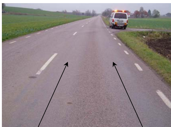
Fig 1: Del av väg 1003 med tydliga blödningar i hjulspåren.
