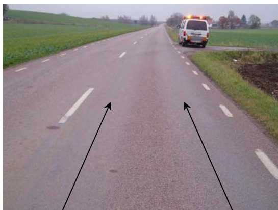
Fig 6.5: Foto av sträcka på väg 1003 vilken visar på tydlig blödning i hjulspåren.
