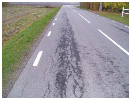
Fig 6.9: Större mängd sprickor i höger hjulspår på väg 1017, sektion 1/240.
