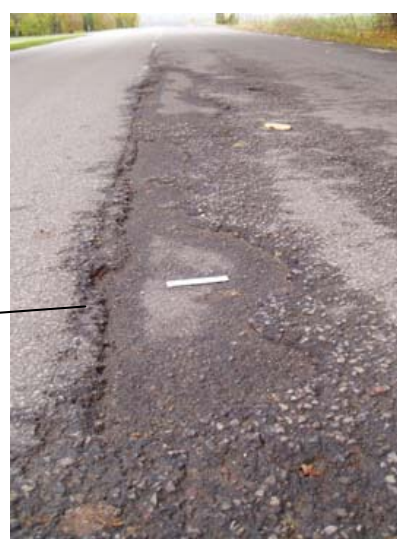
Fig 6.4: Närbild på en del av skadorna
