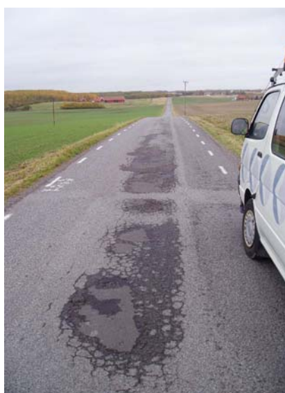
Fig 6.12: Väg 1006. Lagade potthål med krackeleringar runt om.
