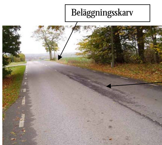
Fig 6.3: Foto från platsen var beläggningsskada och beläggningsskarv är synliga
