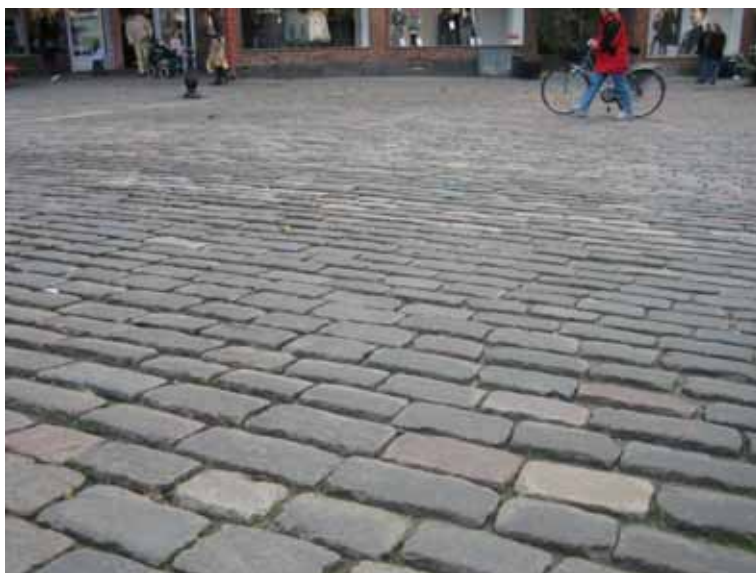
Figur 6.3. Ojämn beläggning på Stortorget.
