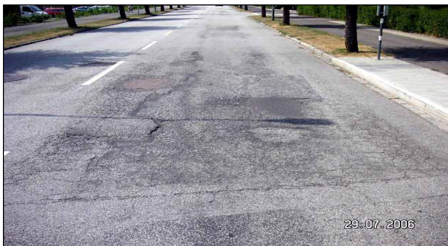
Figur 4.6. Skador vid busshållplatsen Toftängen på Ellenborgsvägen
