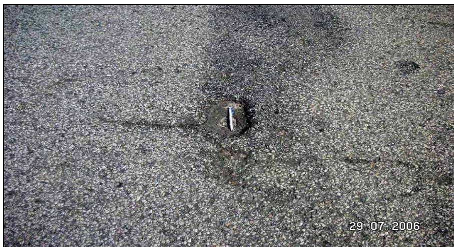
Figur 4.8. Potthål med stensläpp på beläggningsytan. (Pennan är 15 cm lång)
