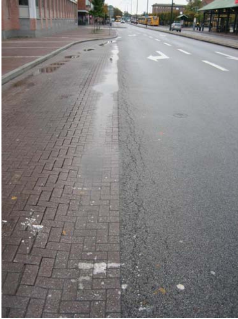
Figur 6.10: Kantsprickor i asfalten vid övergång till betongsten, vid busshållsplats i tillfarten på Spårvagnsvägen. (Foto: Mårtensson, Wilén)
