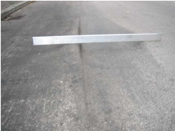
Figur 4.1: Spårbildning på busshållplats Värnhemstorget, Malmö. (Foto: Mårtensson, Wilén)
