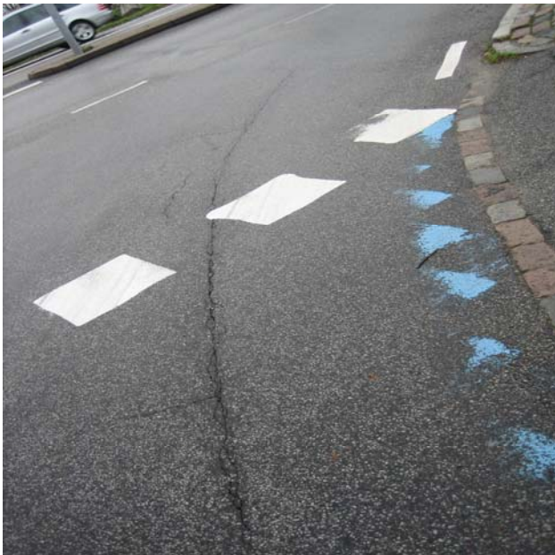
Figur 6.8: Bilden visar på sprickbildning genom korsningen i vägkorset Flygfältsvägen/Segemöllegatan – Vattenverksvägen. (Foto: Mårtensson, Wilén)
