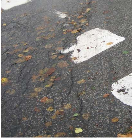
Figur 6.9: Krackelering i högersväng i korsningen Södra Bulltoftavägen – Mölledalsvägen vid bussterminal. (Foto: Mårtensson, Wilén)
