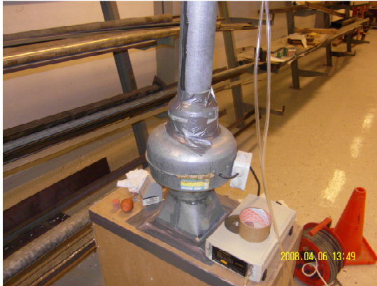
Fig 7 Fläkten med anslutande flödesrör
