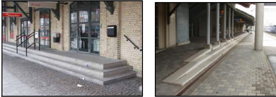
Figur 106 Trappor på östra sidan mot torget (t.v.) i Lund samt trappor mot spår 1 (t.h.)
