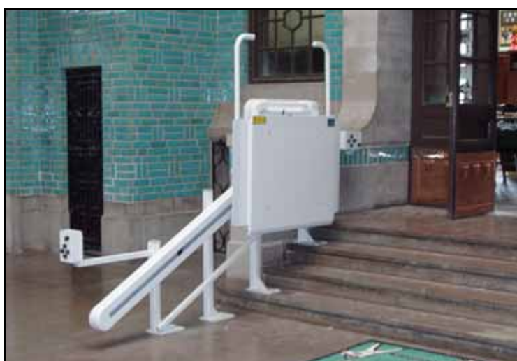
Figur 37 Lyftanordning på Malmö C vid O'Learys
