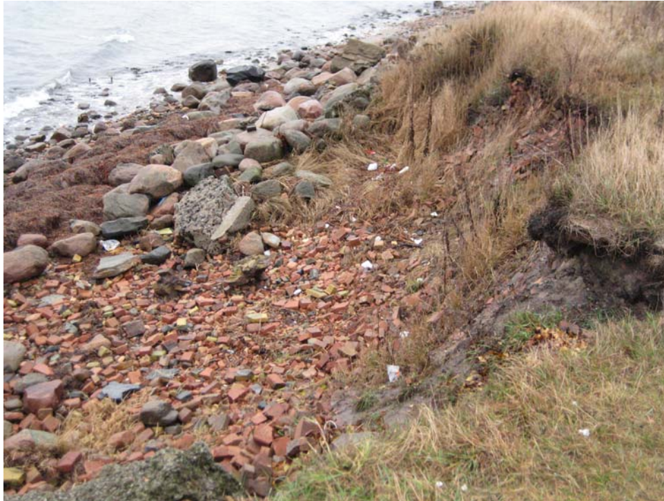
Figur 12-8 – Område mellan Ålabodarna och Sundvik där stenskoningen till viss del rasat och tecken på erosion kan skönjas.
