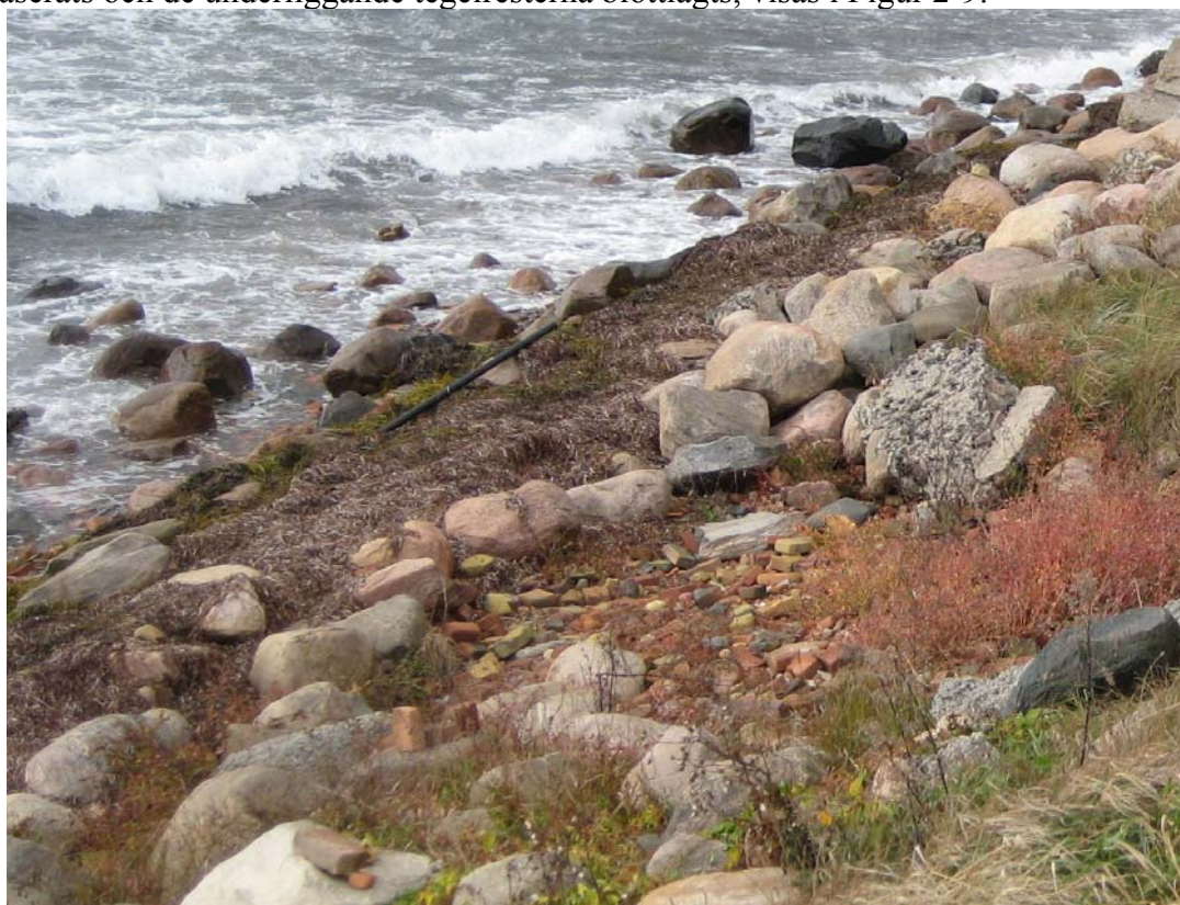
Figur 2-9 – Stenskoning på sträckan mellan Ålabodarna och Sundvik där underlaget har blottlagts och tegelrester är synliga.
