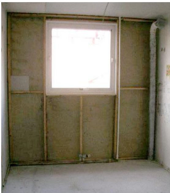
Bild 2:2. Utfackningsväggen inifrån utan isolering, plastfolie och gips. Påvisar reglarnas uppbyggnad gentemot betongstommen.
