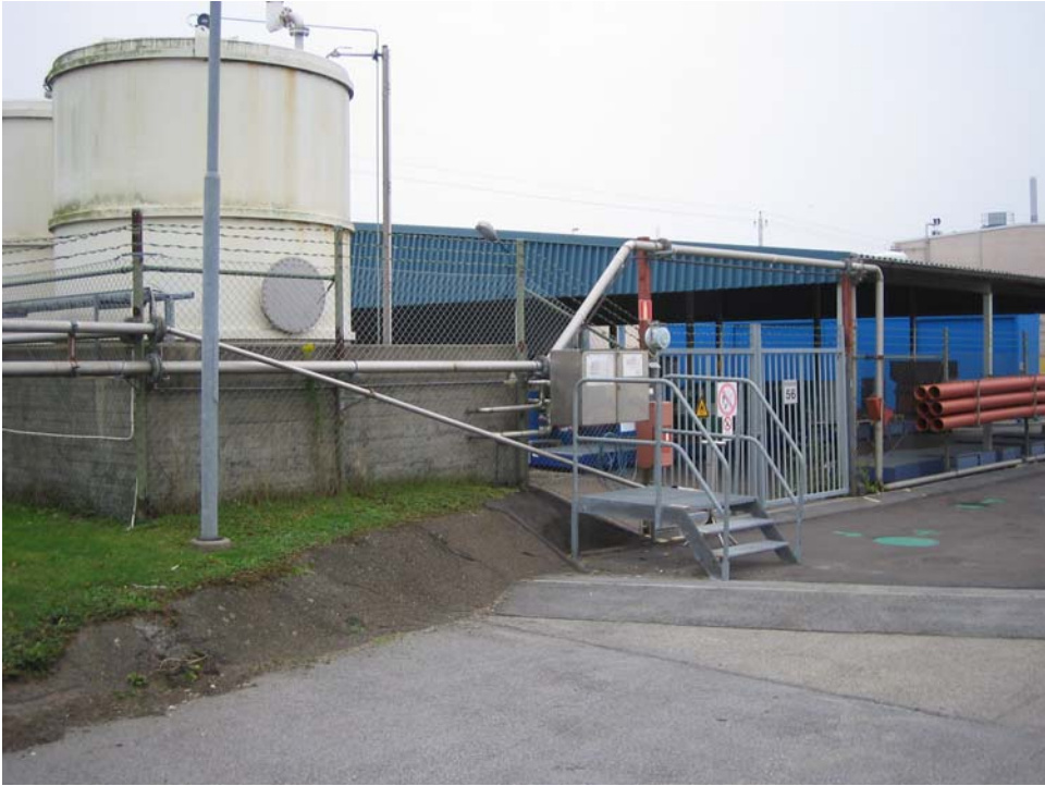
Fabrikens tankfarm sett från inkörningsgrinden för lastbilar
