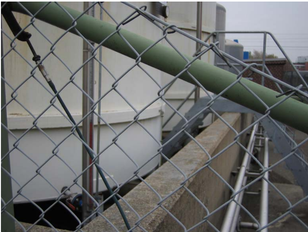
En del av invallningen för uppsamling av metanol vid läckage
