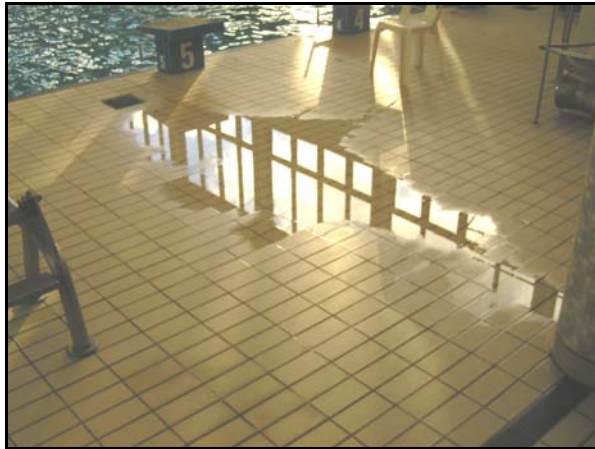
Figur 9.4 Vattenpöl som kunde ha undvikits genom att ha avloppsränna istället för punktavlopp.
