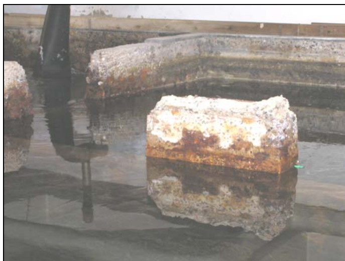
Figur 9.11 Omfattande armeringskorrosion på utjämningsstank.
