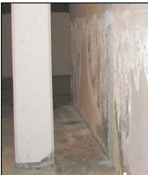
Figur 6.7 Utfällningar som följd av otät betong.
