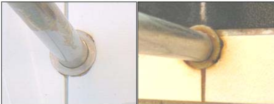
Figur 6.10 Infästning av lejdare i klinkerbassäng. Vänstra bilden visar en infästning under vattenytan med väldigt lite korrosionsangrepp. Högra bilden visar en infästning i skvalpzonen som har tydliga korrosionsangrepp.
