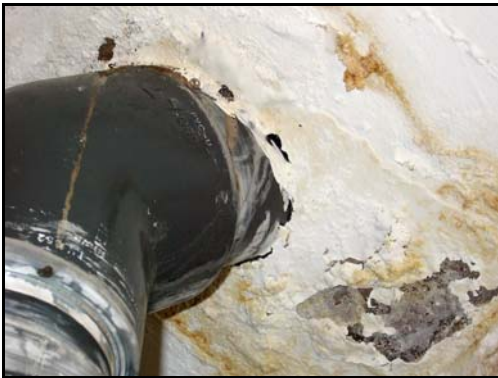
Figur 6.6 Läckage som följd av otät genomföring.
