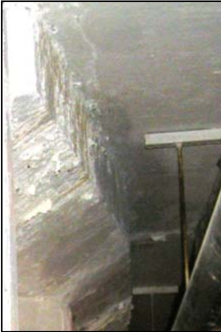
Figur 6.5 Läckage som följd av dålig lösning av anslutning mellan bassäng och bassängdäck.
