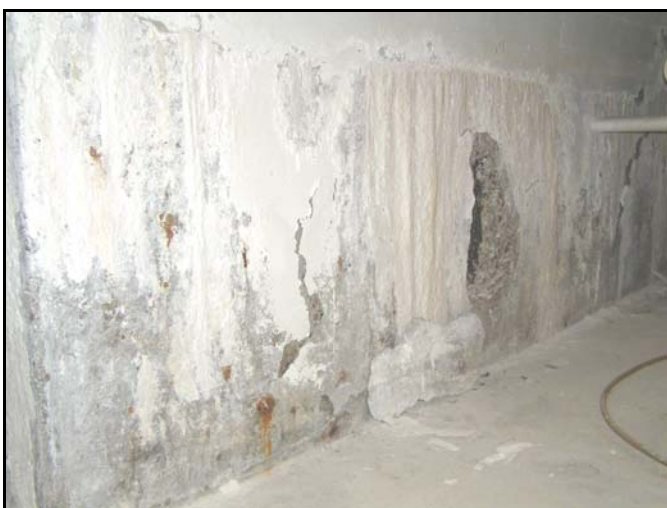
Figur 6.8 Avspjälkningar som följd av armeringskorrosion.
