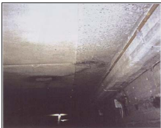
Figur 14.8 Anodnät ingjutet i cementputs på bassängdäckets undersida [49].
