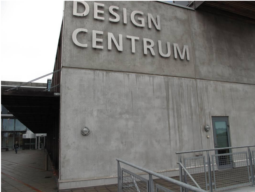
Bild 3.3 – Kalkutfällningar har gjort fasadelementen på IKDC vitflammiga.
