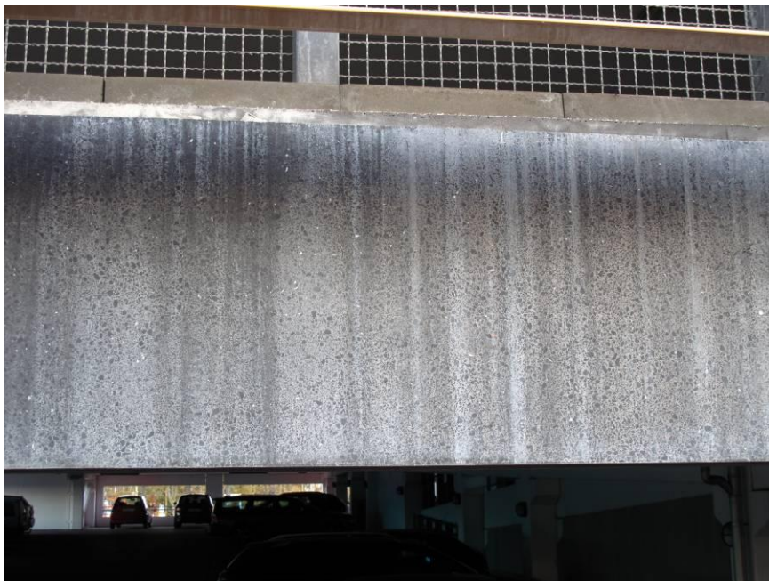
Bild 3.5 – Vatten har runnit längs betongytan vilket gett vita rinningsmärken bestående av kalcit.
