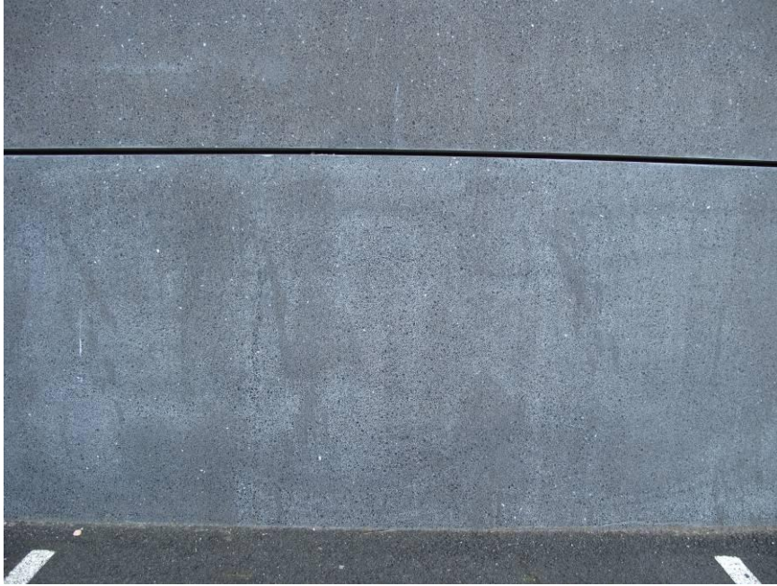
Bild 3.4 – Den pigmenterade och slipade betongytan är missfärgad av kalkutfällningar.
