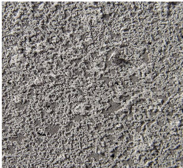
Bild 5.9 – Utfällningar på betongytan efter pölprovsförsöket.
