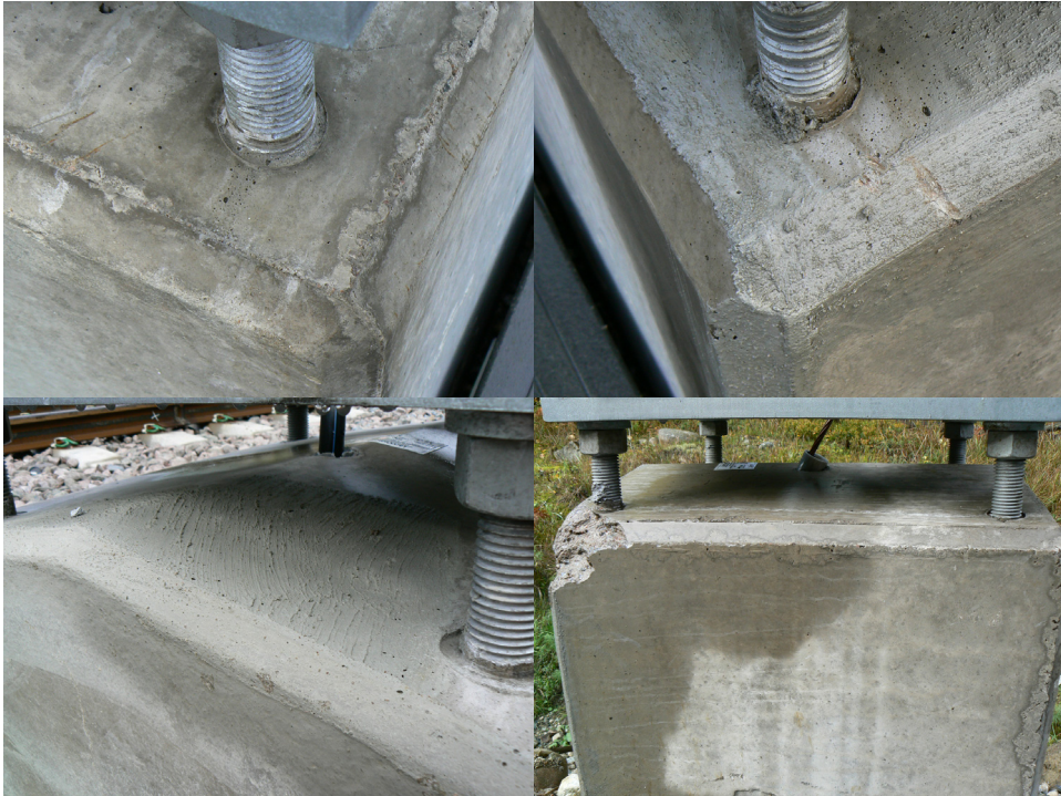
Figur 6.1 Deltalj bilder på de bultar som fäster fotplattan till fundamentet. I figurerna syns bl.a. spalter mellan bultar och fundament. Foton tagna längs med tågsträckan Västra Hanninge-Nynäshamn
