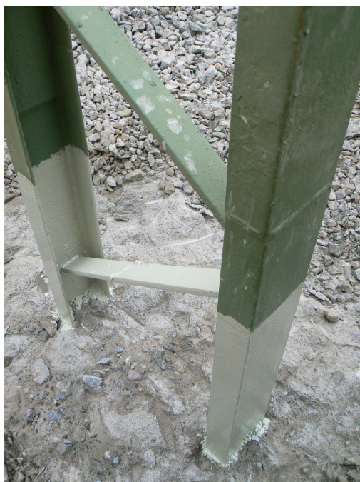
Figur 4.19 Nedre del av kontaktledningsstolpen efter att ingjutet gods tagits fram i dagen, blästrats och målats med primer. Inga synliga korrosionsangrepp står längre att finna
