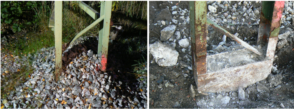
Figur 4.14 Till vänster kontaktledningsstolpen innan arbetet påbörjats, fundamentet befinner sig här helt under makadam. Till höger frilagt korrosionspåverkat stål
