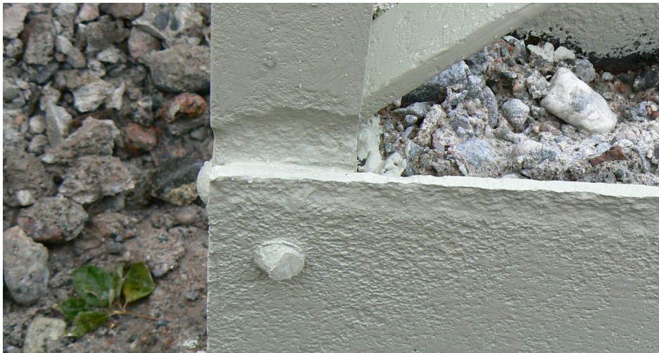
Figur 4.7 Område som angipits hårt av korrosion. Foto taget efter att blästring och målning med primer genomförts
