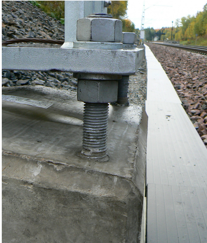
Figur 2.5 Bultar vilka sammanfogar fotplatta samt fundament. Foto taget längs med tågsträckningen Västra Hanninge-Nynäshamn
