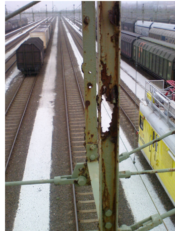
Figur 2.1 Bitvis kraftigt korroderad brygga, Göteborg (Ulvdal 2009)
