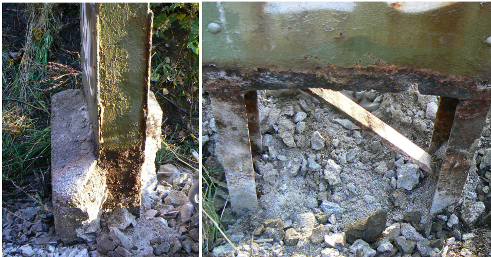
Figur 4.16 Fotot till vänster visar nedre del av kontaktledningsstolpen samt fundamentet då arbetet med att bila ned betongen precis startat. Fundamentets ovansida slutar strax ovan de plåtar som sitter mellan stolpens båda ben. Till höger korrosionspåverkat stål efter att fundamentet avlägsnats
