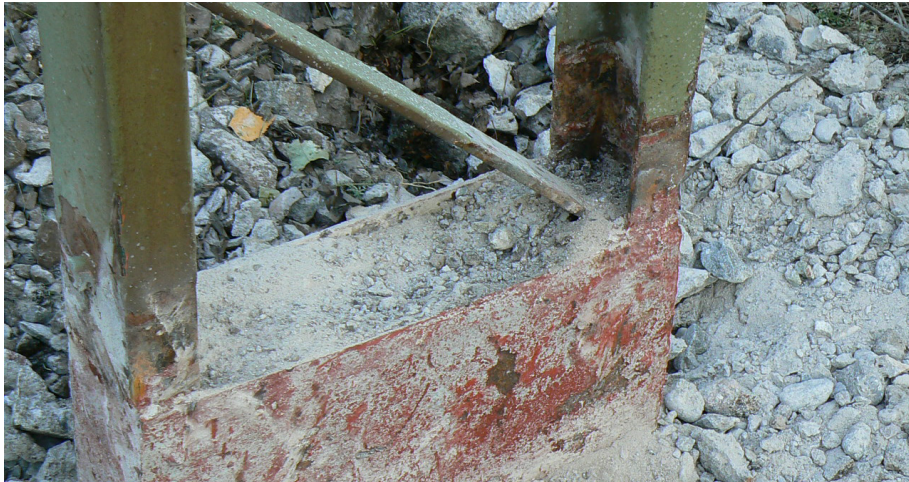
Figur 4.6 Den del av kontaktledningsstolpen som varit ingjuten i fundamenttopp. I området där fundamenttoppens ovansida tidigare befunnit sig syns korrosionsangrepp
