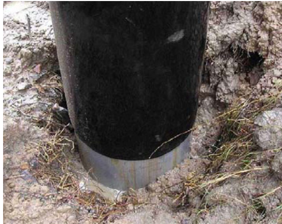
Figur 2.9 På fundamentröret utanpåliggande plaströr. Betong ses här tryckas upp till marknivå (Stenman 2005, s.13)
