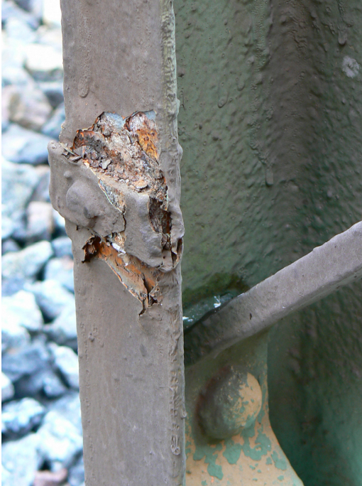
Figur 4.11 Korroderad detalj hos kontaktledningsstolpen, sannolikt orsakat av spaltkorrosion
