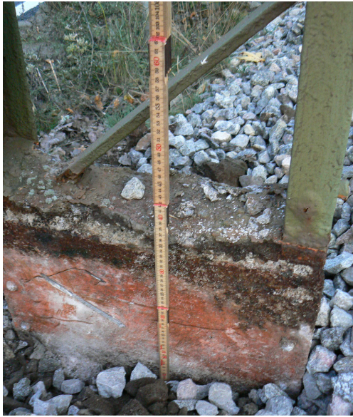
Figur 4.9 Frilagt gods samt korrosionsangrepp efter slutfört bilningsarbete
