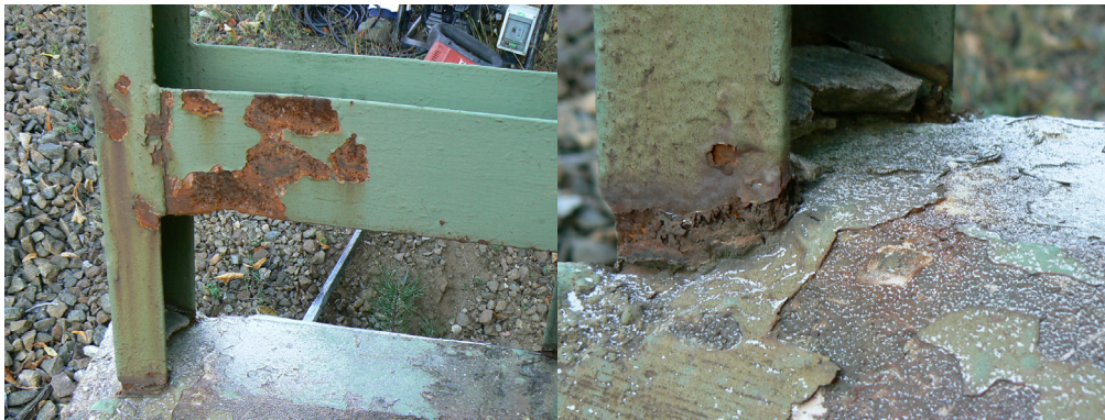
Figur 4.4 Kontaktledningsstolpens infästningspunkt i fundamenttoppen visas till vänster. Detalj av infästningspunkten där korrosionsangrepp tydligt framkommer visas till höger
