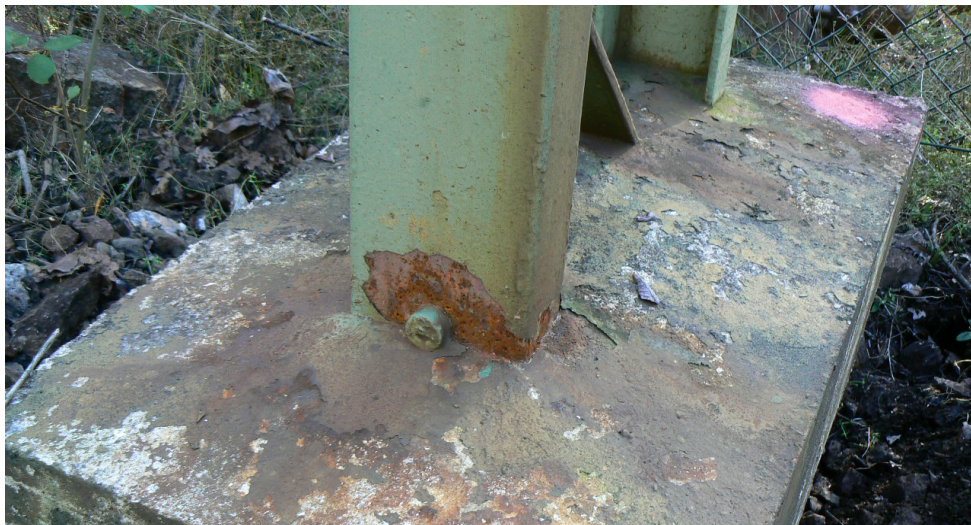
Figur 4.5 Övergång mellan kontaktledningsstolpe och fundament. Längst ned på båda balkarna syns rostantydning
