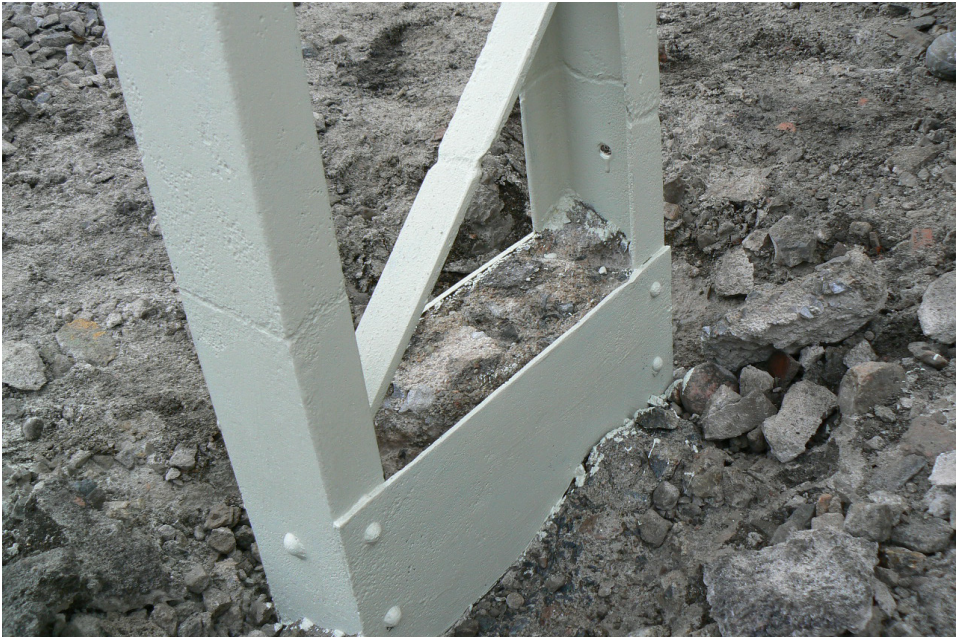
Figur 4.15 Nedre del av kontaktledningsstolpen efter att fundamenttoppen bilats bort, blästring och målning med primer genomförs. Ränder syns där korrosionsangreppet verkat
