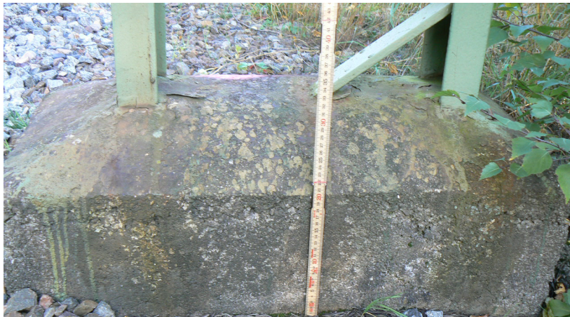
Figur 4.17 Fundamenttopp samt nedre del av kontaktledningsstolpe. I figuren syns på vänster UNP-balk en missfärgning i gränsytan mellan betong och stål
