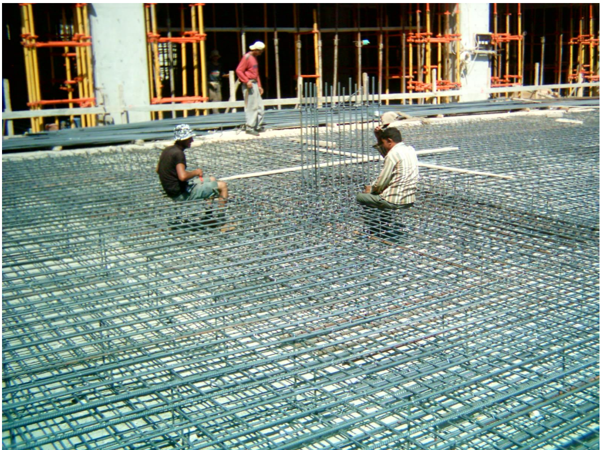
Figur 5.3 En hel del armerad platta på mark på ett bygge i Beirut
