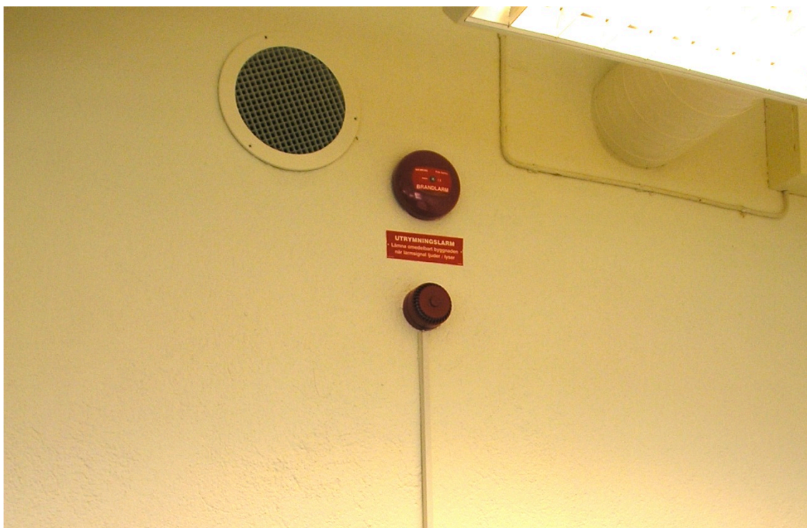
Figur 13. Bilden visar siréner i övnings sal MH:331 med en kabellist och utrymningsskylt fastsatt intill. Siréner användes i utrymningsförsök nummer 1 och 3.
