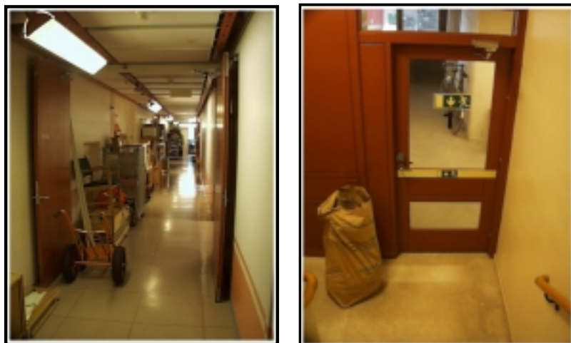
Bild 6.1 och 6.2: Blockering av korridor och brandcellsavskiljande dörrar samt brännbart material i utrymningsväg.
