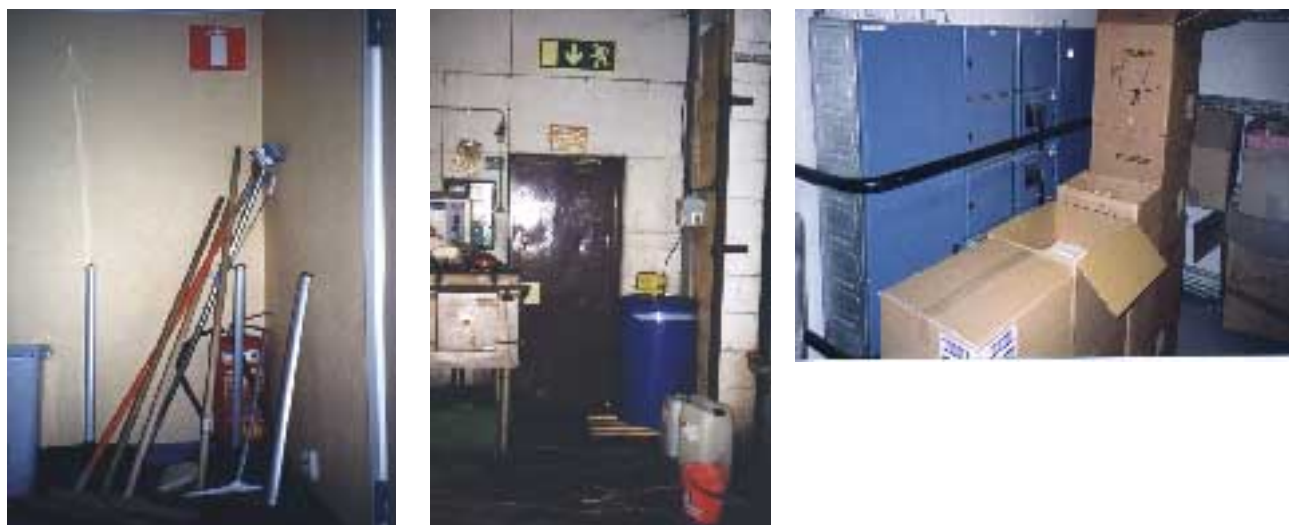
Figur 7.6 Blockerad brandsläckare (vänster), blockerad nödutgång (OBS! Lägg märke till slangarna framför dörren = snubbelrisk) (mitten), brandbelastning i elcentral (höger).
