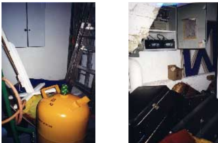
Figur 7.15 F-gas behållare och brännbart material i elcentral (vänster), brännbart material i elcentral (höger).
