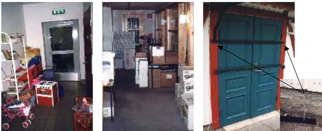
Figur 7.4 Blockerad utrymningsväg på dagis (vänster), avsaknad av nödutgångsskylt samt blockerad brandsläckare (mitten), igenbultad utrymningsväg (höger), 10 cm lång bult (infälld bild).
