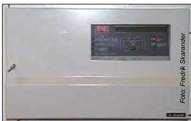
Figur 2.1 Foto på centralapparaten hos brandlarmsystemet EBL512.
