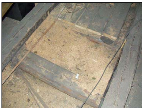
Figur 4.13.1 Bilden visar ett vindsbjälklag som är isolerat med sågspån.
