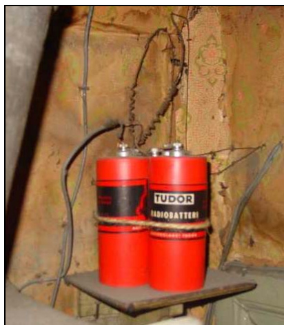
Figur 3.2.2 Batteri och kablar som använts i ett köksskåp i en gammal träbyggnad.
