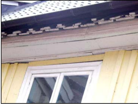
Figur 4.12.1 En otät takfot ovanför ett lägenhetsfönster som saknar brandteknisk klass.
