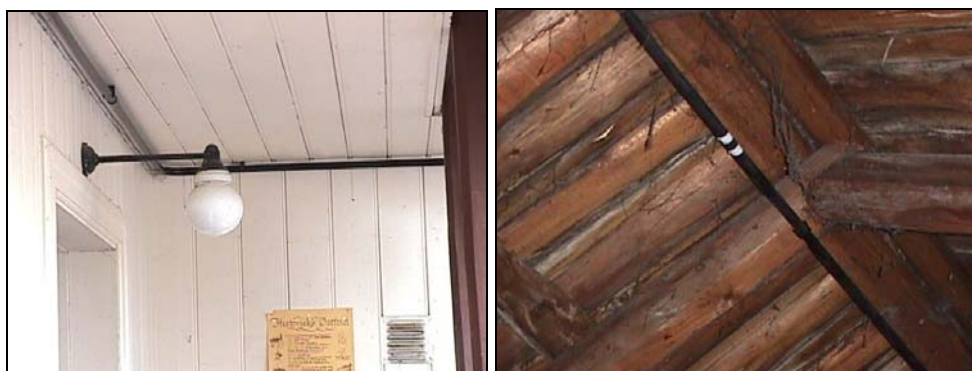
Figur 5.3.2 Bilderna visar hur rörslingorna till de aspirerande rökdetektorerna placeras under takfoten och under taknocken på ett vindsutrymme. Bilderna är tagna av /38/.
