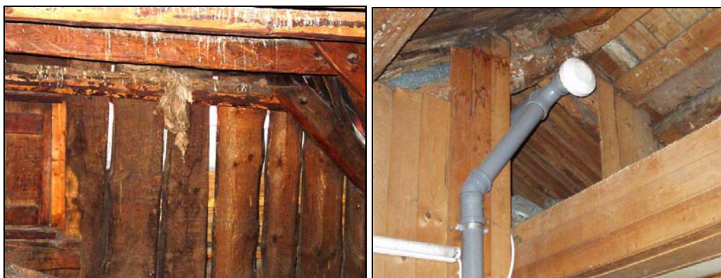
Figur 4.11.1 Bilden till vänster visar en otät vindsvägg i fastighetsgränsen. Bilden till höger visar en otät sektionering av en mycket stor osektionerad vind.
