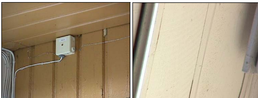
Figur 5.3.1 Bilden till vänster visar hur den värmedetekterande tråden kopplas samman med larmöverföringssystemet. Till höger syns den värmedetekterande tråden som det högra vertikala strecket i mitten av bilden. Denna bild är tagen på undersidan av en takfot. Bilderna är tagna av /38/.
