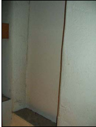
Figur 4.14.1 Hålltagning för en dörr i en brandmur. Någon dörr är inte monterad och dörröppningen är igensatt med en träskiva.
