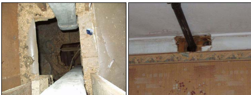
Figur 4.7.1 Bilden till vänster visar en otätad håltagning i ett mellanbjälklag som är cirka 6 dm 2 stort. Bilden till höger visar en otätad genomföring i en vägg mellan ett vindsutrymme och ett kontor.
