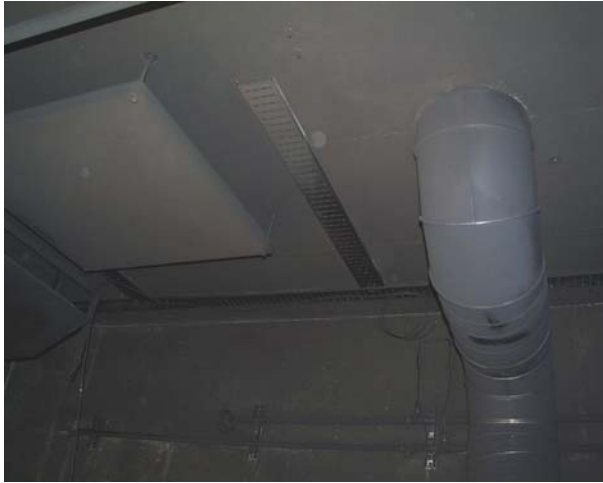
Bild 2.5 Frånluftsdonet i föreläsningssalen är placerat ovanför plåten i taket. Kanal till tilluft (th).
