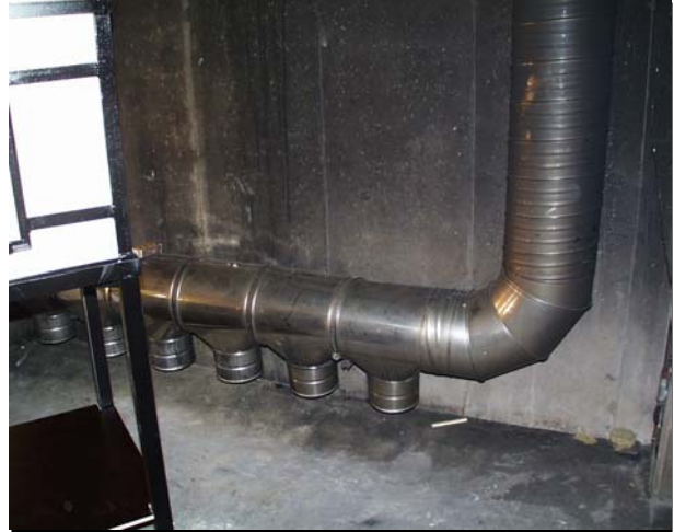
Bild 2.6 Tilluftsdonen är placerade i en kanal längs golvet i föreläsningssalen.
