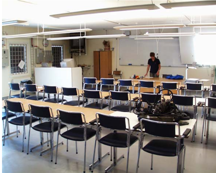
Bild 2.1 Bild över lektionssalen. Framme till vänster finns datorn som styr ventilationen i föreläsningssalen och detektorrummet. På väggen finns centralen för styrning av släckmedel.
