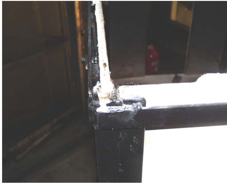
Bild 4.20 U-profilerna har svetsats med svetsfogar på 5cm med 10cm mellanrum. Springorna mellan de två profilerna har inte tätats, förutom tätningseffekten som färgen bidrar med vid målning av konstruktionen. Drevning med keramisk isolering i U-profilerna utförs utifrån.
