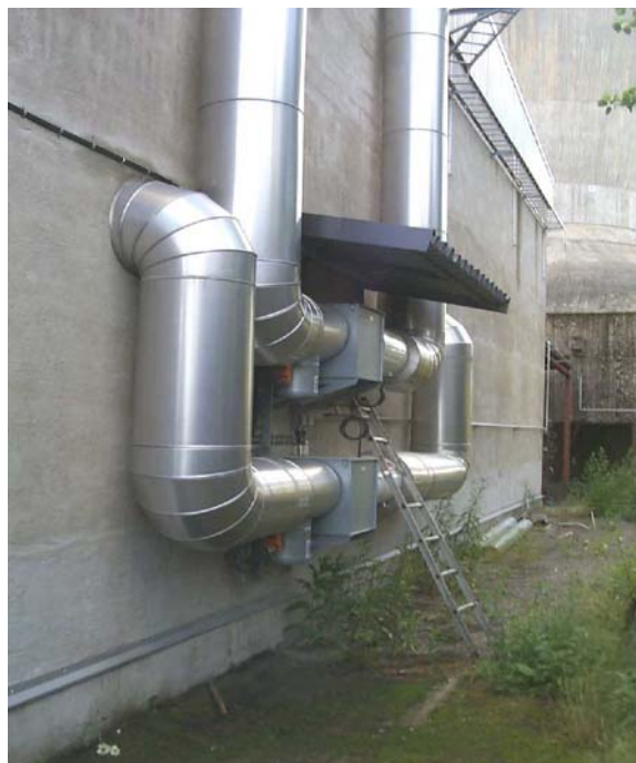
Bild 4. Gasolanläggningen som värmer övningsrummen i brandhallen
