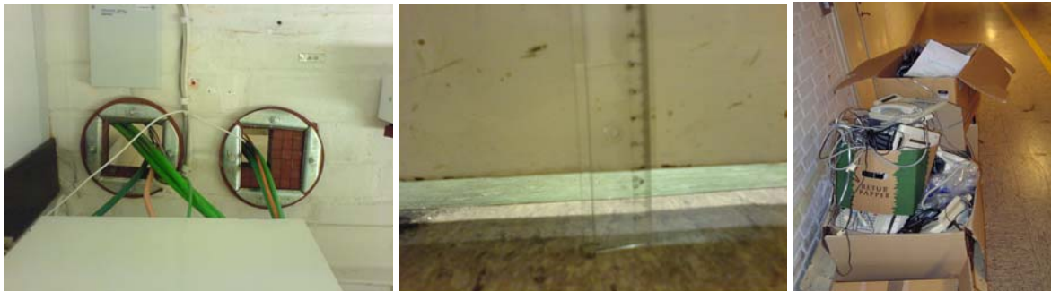
Figur 6.1 T.v bristfälliga kabelgenomföringar, Mitten springa under dörr, T h. uppställt material i källarsystemet.
