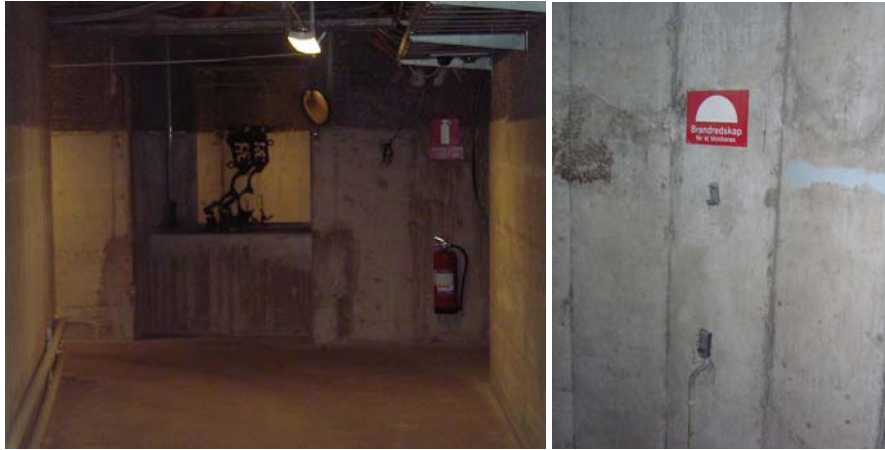
Figur 3.2 T.v. Pulversläckare i gångtunneln intill starten vid den sydvästra delen och t.h. avsaknad av brandsläckare i nedre nödutgång från gångtunneln.
