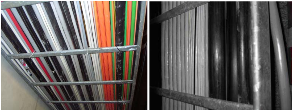
Figur B.2 Undre respektive övre kabelstegen.
