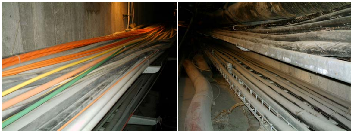
Figur 6.16 Kablar i kabelkulverten på vänstersida respektive högersida sett från startdelen närmast den sydvästra anläggningen.
