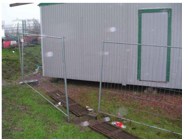
Figur 5.1 Exempel på bristfällig avspärning.
