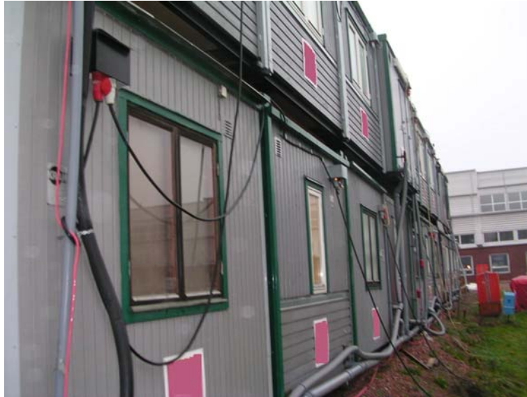
Figur 5.2 El-ledningar på arbetsbodarnas utsida.
