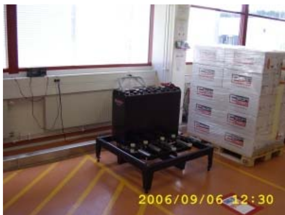
Figur 5.6. Truckladdningsplats nära brännbart material.
