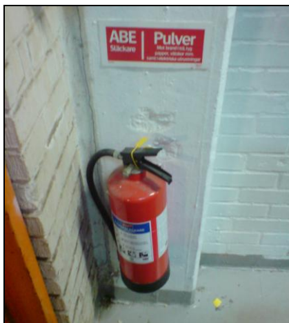
Figur 6. Pulversläckare i backhallen. (Foto: Andersson S, 2007)
