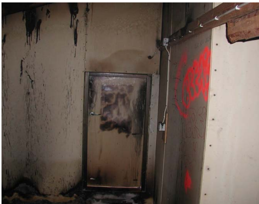
Figur A 5. Stängd dörr i brandcellsgräns.
