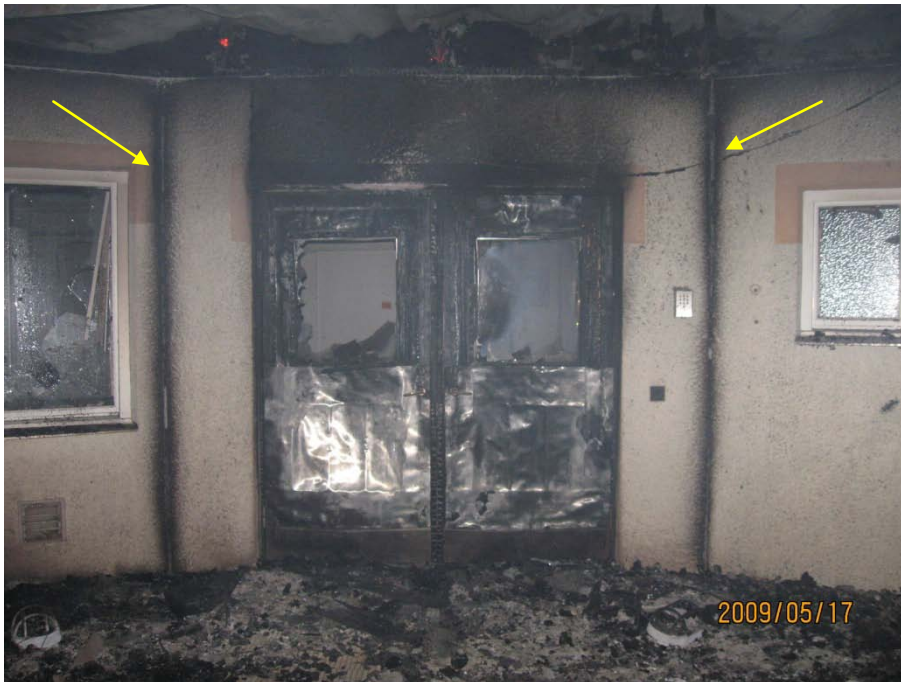
Figur B 20. Bilden tagit av polisen klockan 04.30. Pilarna indikerar värmestrålningsskador på fogmassa mellan väggpanelerna.
