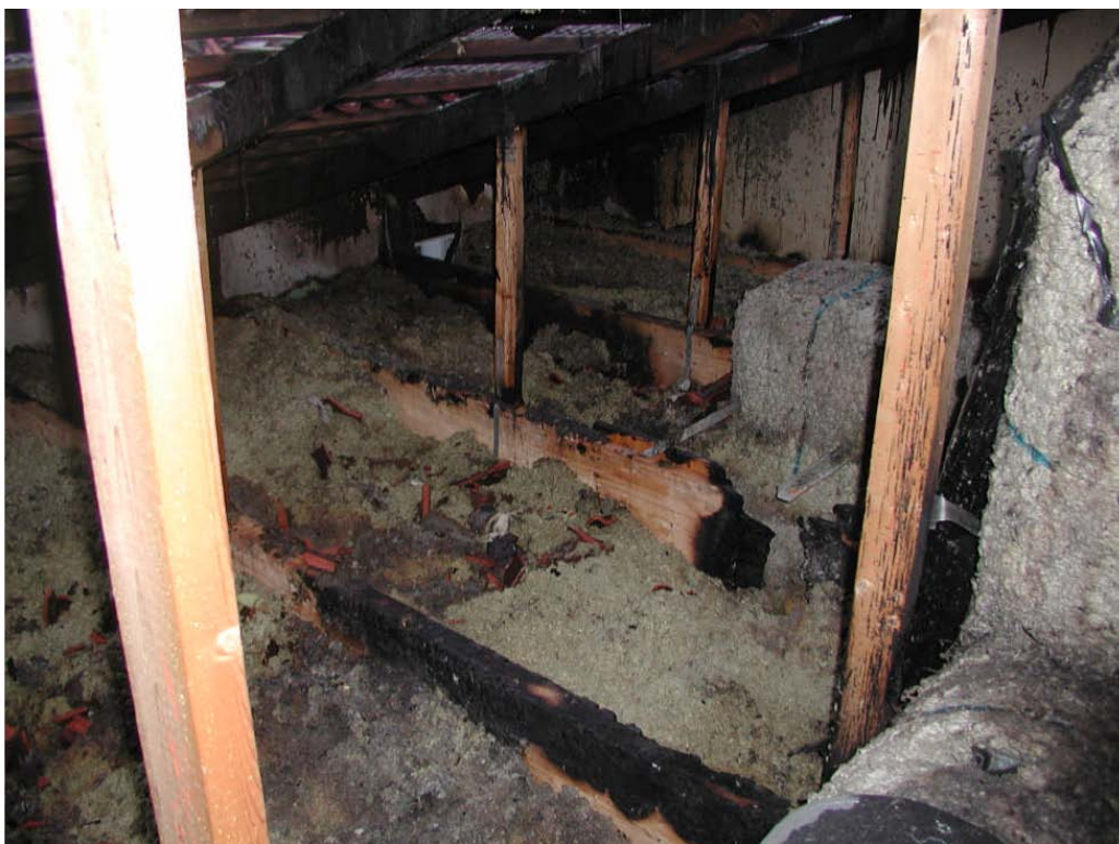
Figur A 3. Urbränningsskador på limträbalkar.
