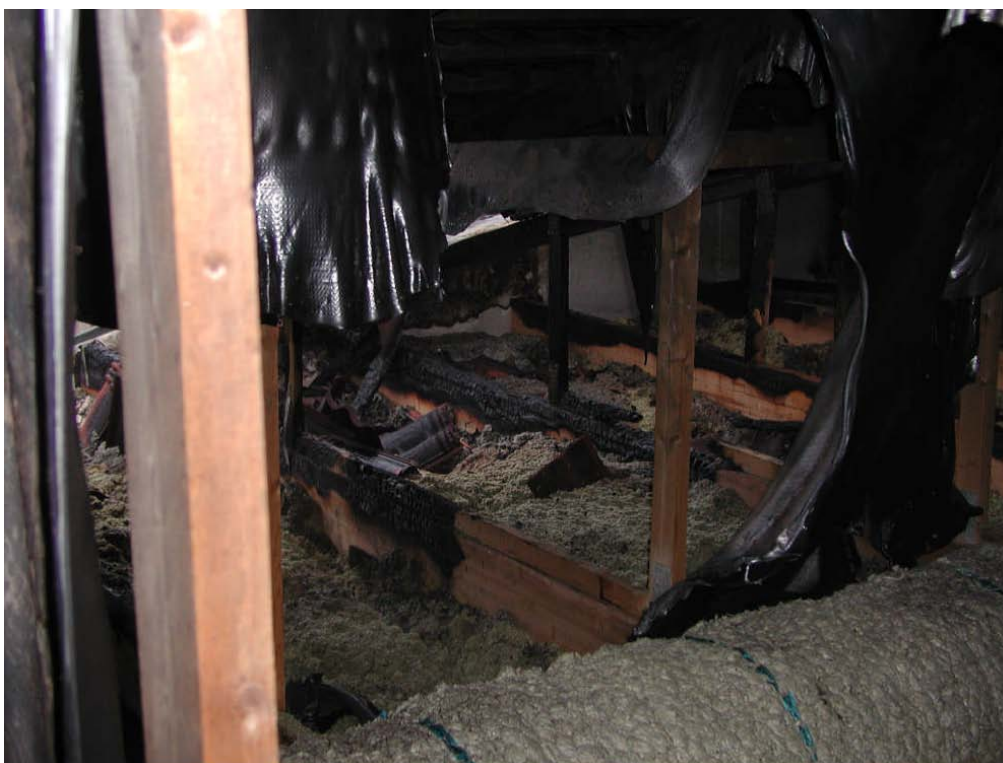
Figur A 8. Bränd plastfolie som utgjorde undertak på vinden.
