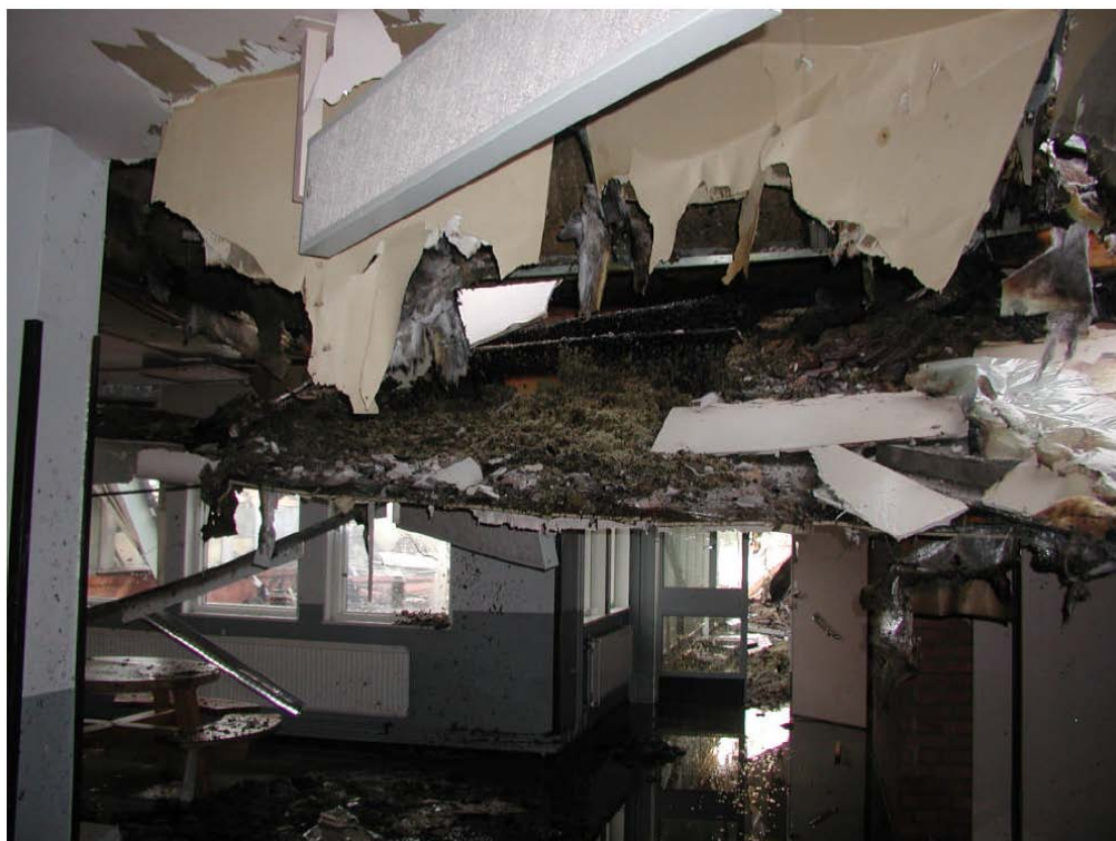
Figur A 7. Ras i ett rum beroende på avbrända balkar.
