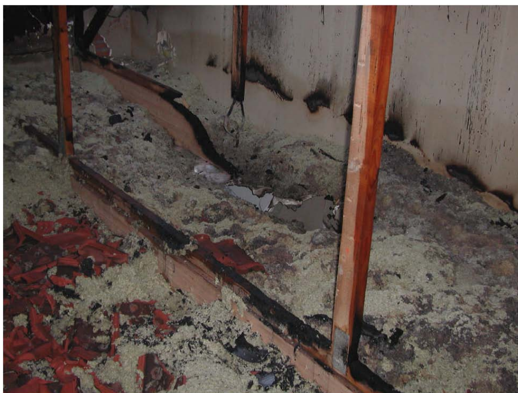
Figur A 4. Urbränningsskador på limträbalkar.
