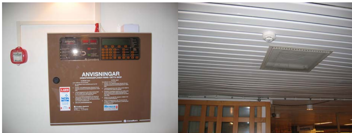
Figur 2.8 Brandförsvarstablån samt rökdetektor i biblioteket
