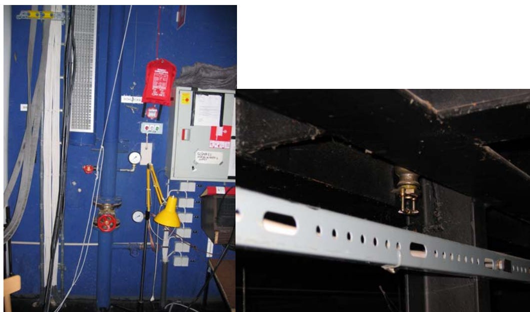
Figur 2.7 Manövrering av sprinklersystem och brandgasventilation på scenen. Sprinklerhuvud ovanför scenen
