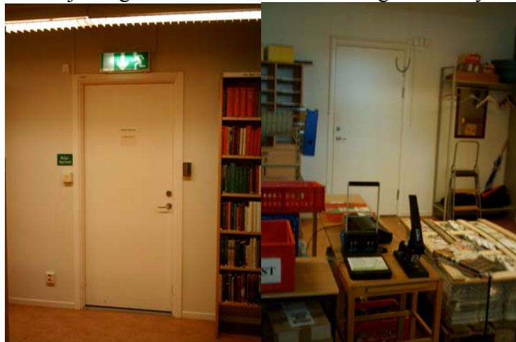
Figur B.1 Blockerad nödutgång. Fr. v. sedd inifrån biblioteket, utrymningsvägen innanför
