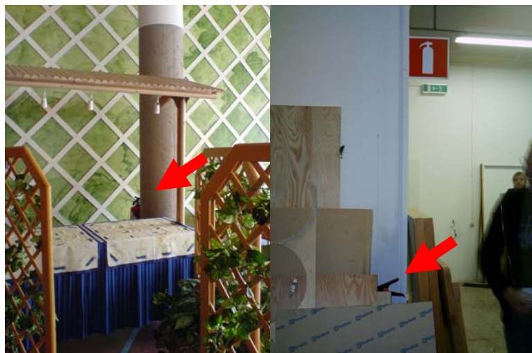
Figur B.2 Icke markerad och blockerad brandsläckare
