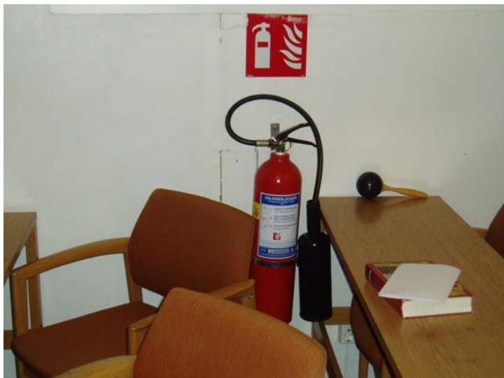
Figur 7.4 Exempel på svåråtkomlig brandsläckare
