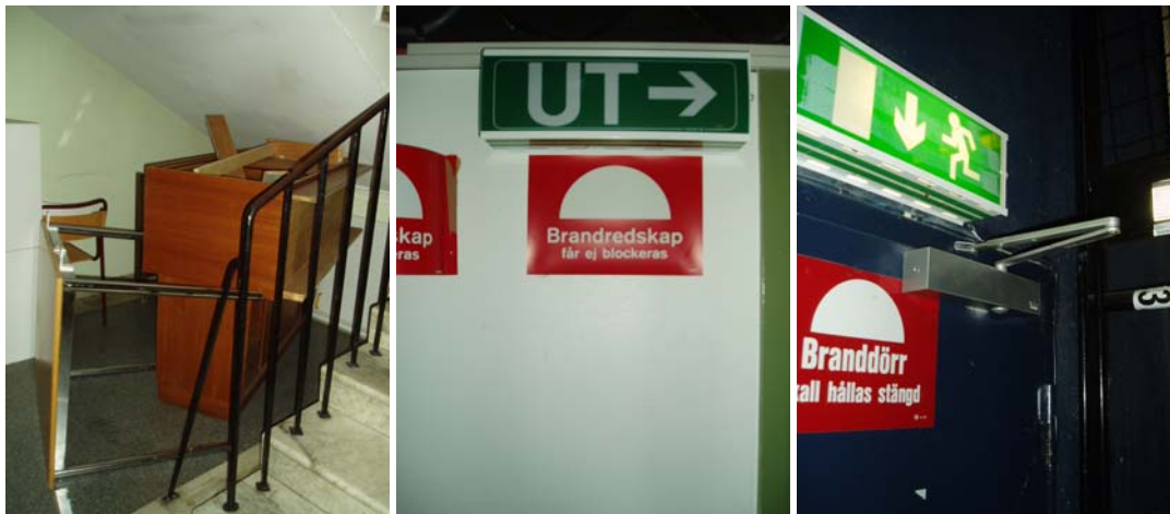
Figur 7.1-7.3 Exempel på bråte i utrymningsväg och ej fungerande respektive fungerande genomlyst utrymningsskylt.
