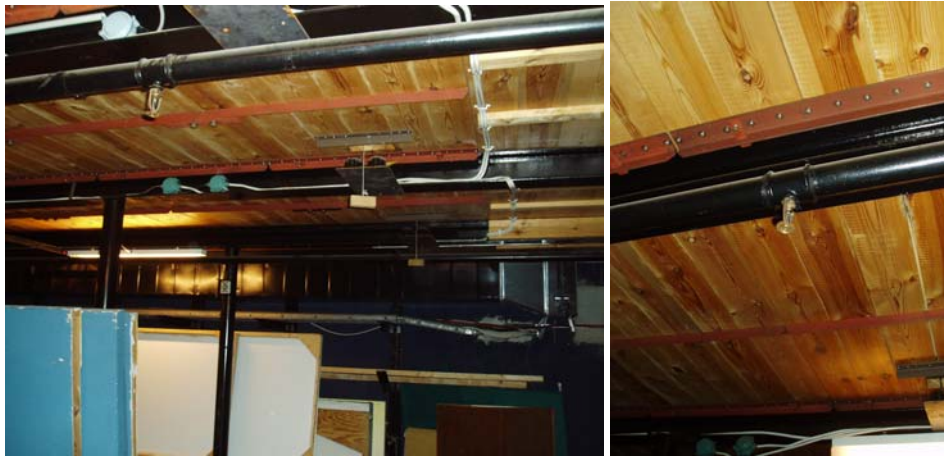
Figur 2.20 och 2.21 Sprinkler i scenkällaren
