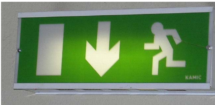
Figur 44, bild på utrymnings skylt
