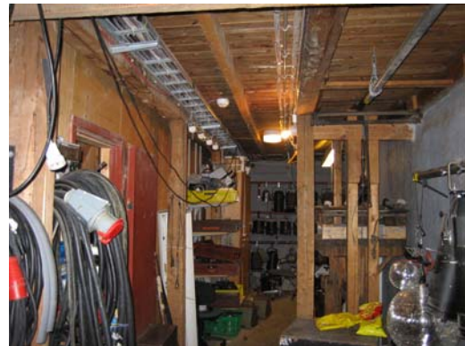
Figur 8, bild från el-centralutrymmet
