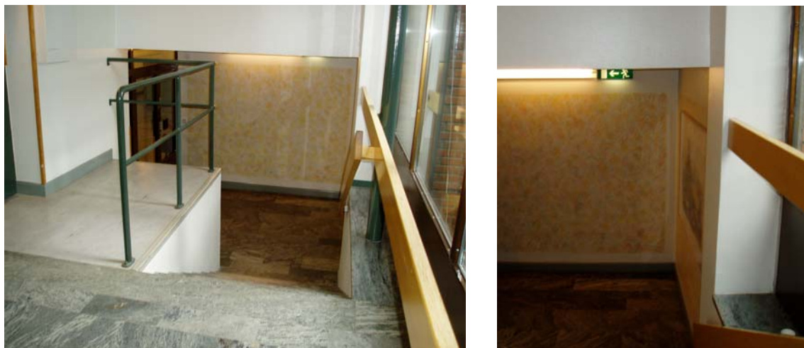
Figur 11.3 Utrymningsskylten i trappan mellan annexets korridor och foajé är dåligt markerad.
