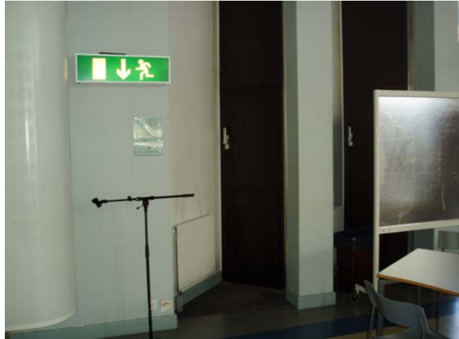
Figur 9.2 De två smala dörrarna vid aulans södra långsida. Dörrarnas bredd är ca 0,7 m och de är dåligt skyltade. En dörr är även skymd och blockerad av föremål.
