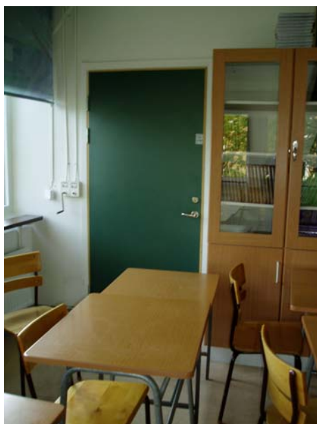
Figur 11.1 Dålig framkomlighet i utrymningsväg.
