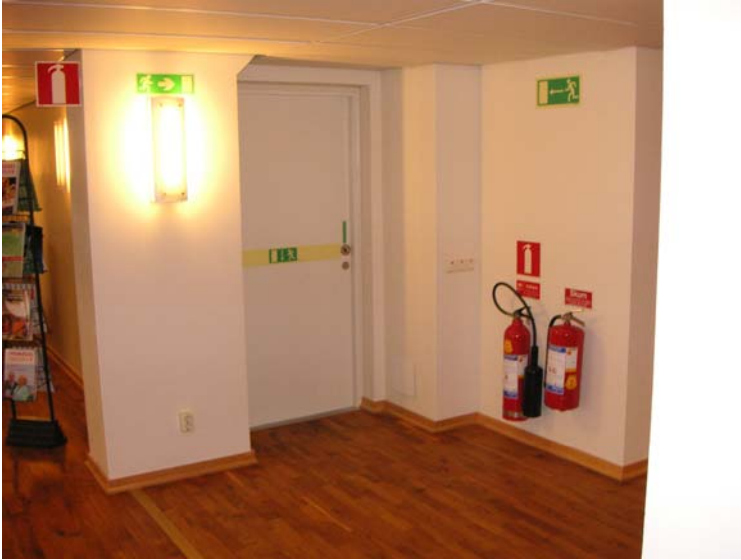
Figur 22. Dörr till utrymningsväg och handbrandsläckare på Univar AB.
