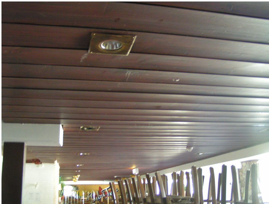
Figur 9-1 – Brännbart material i Bodegan.
