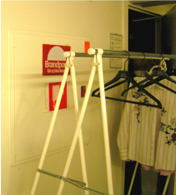
Figur 12-5 - Exempel på blockerad brandpost.
