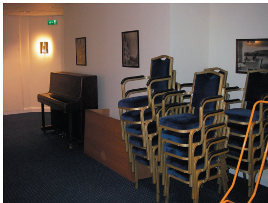
Bild 7. Lös inredning i utrymningsväg.
