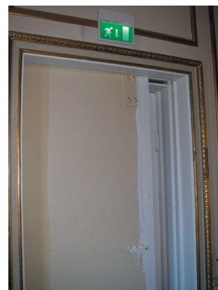
Bild 10. Skjutdörr i utrymningsväg
