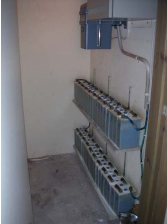
Fig. 4 Bild på batteribackup i källaren
