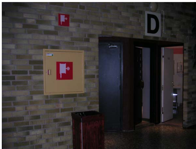
Fig. 1. Bild på inomhusbrandpost inne i entrén
