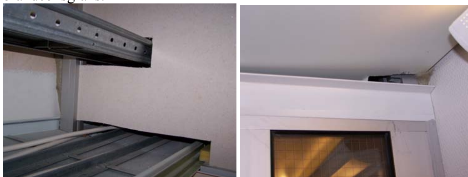
Figur 2.4: Ny branddörr med otäta genomföringar.
